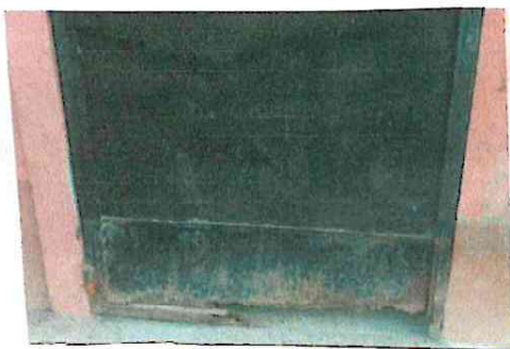
Foto 5: Puertas de Aulas
